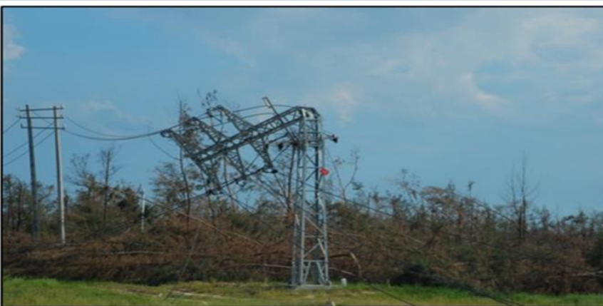
文昌龙楼镇受损的输电塔
